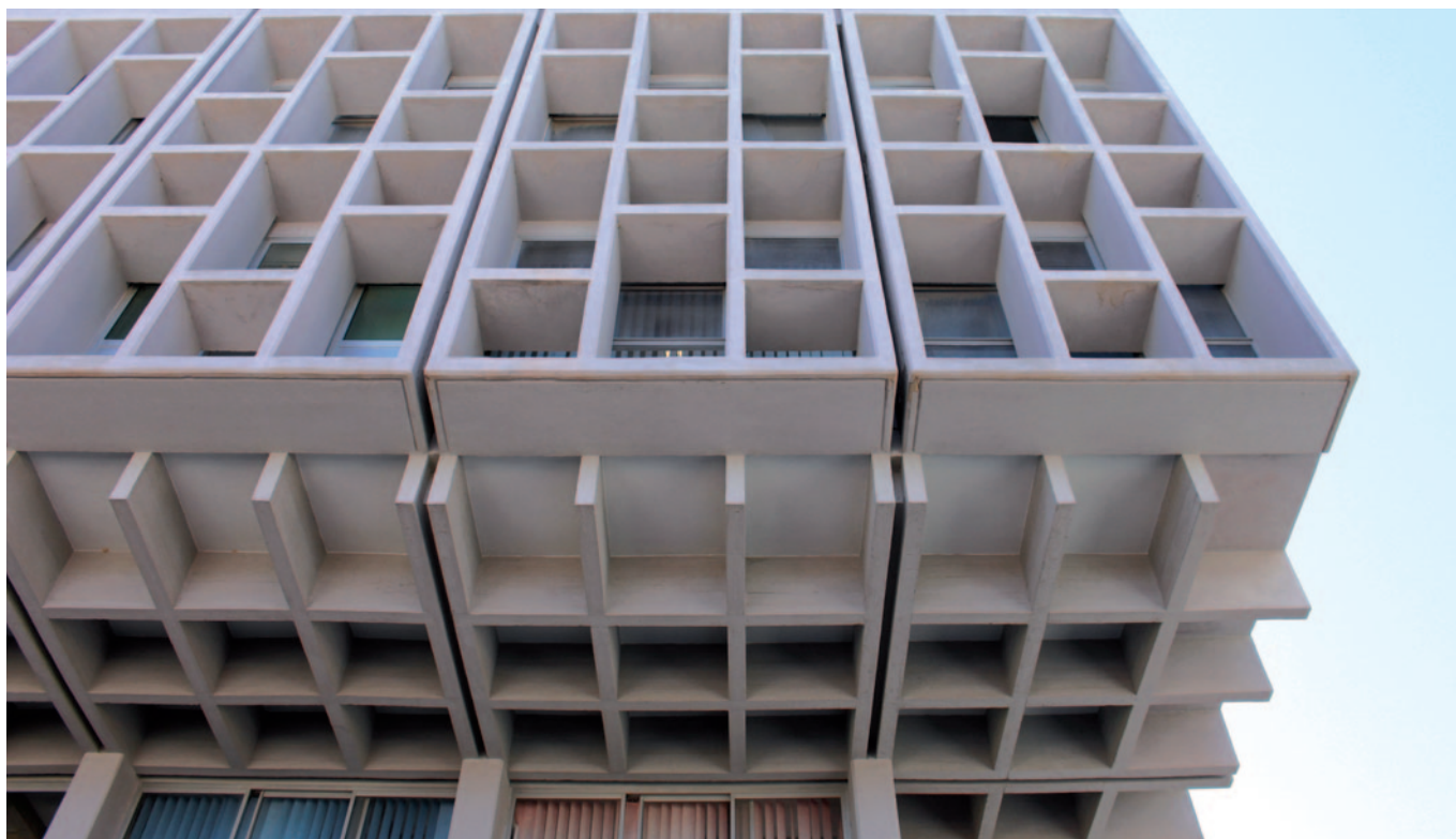
Fig. 14. Palazzo di Giustizia di Ragusa, dettaglio della struttura alveolare aggettante in calcestruzzo armato a faccia vista, 2024.
