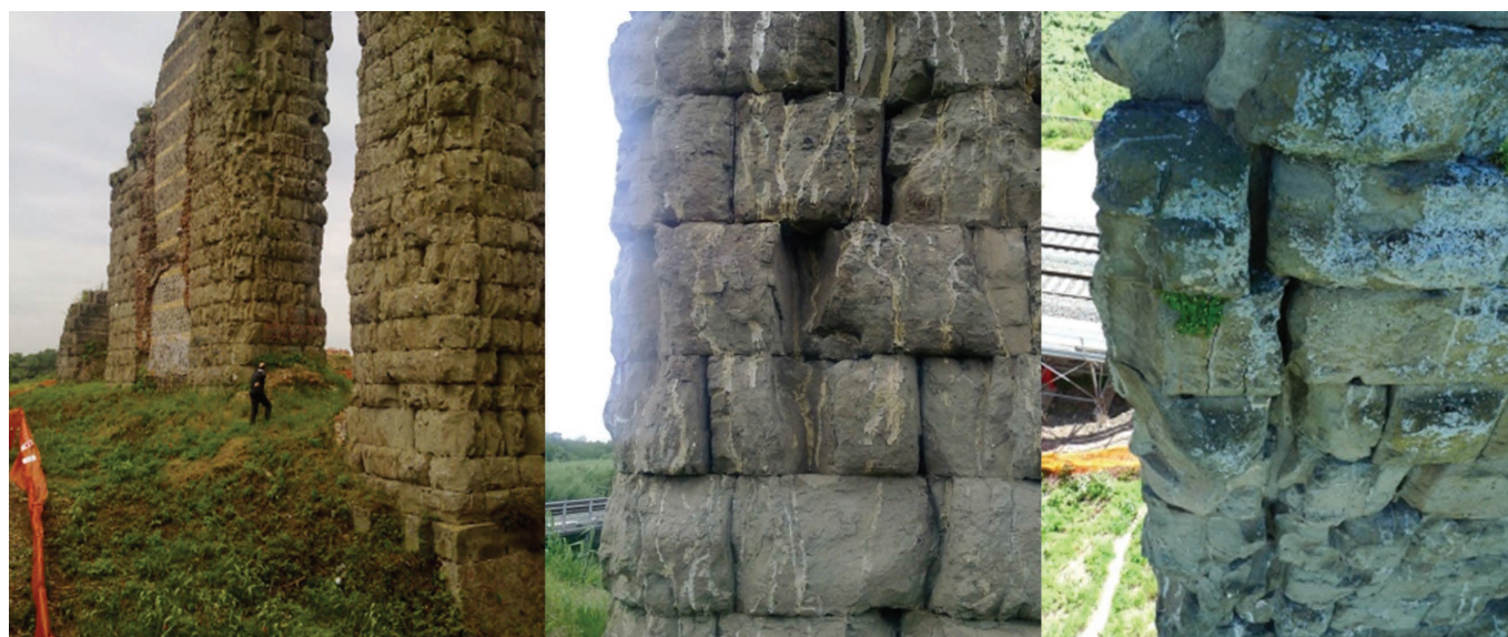
Fig. 9. Alcune immagini sullo stato di degrado corticale dei blocchi sul perimetro esterno della struttura. A sinistra alcuni pilastri del tratto delle sei arcate adiacenti alla ferrovia Roma-Cassino, con la tamponatura ottocentesca in muratura listata, che presentano uno stato di diffuso degrado evidenziato da fessure sub verticali e distacchi; la gravità del fenomeno degenerativo si apprezza meglio nelle immagini di dettaglio in cui si osservano anche le mancanze conseguenti e le striature di un precedente restauro con prodotti non visibili al momento dell'esecuzione.
