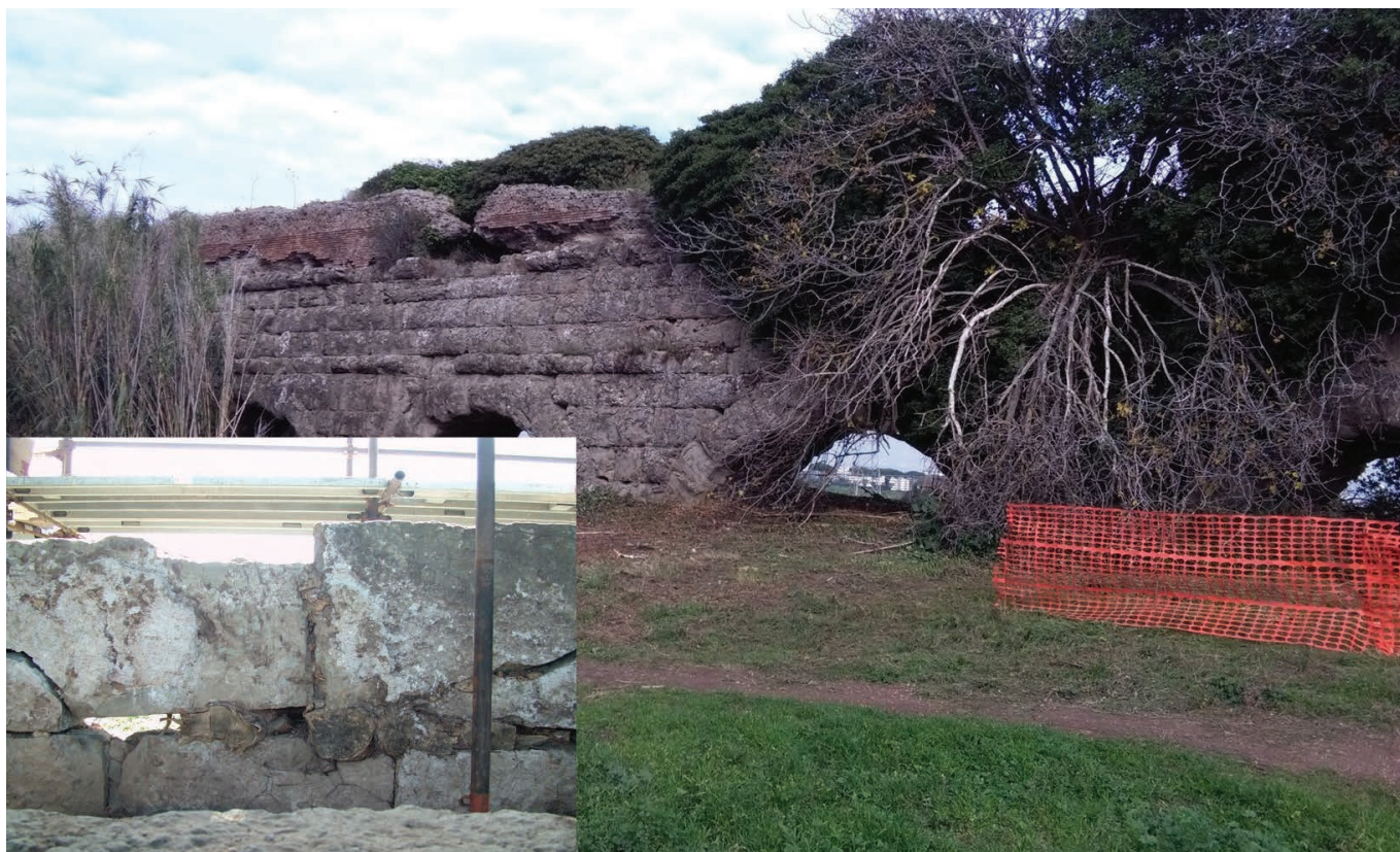
Fig. 13. Una pericolosa ma non rara presenza vegetale (aliante), lasciata svilupparsi per incuria o per un errato senso del pittoresco, ha arrecato danni consistenti alla struttura per l'effetto cuneo dell'impianto radicale e per le vibrazioni trasmesse dalla chioma esposta al vento. Nel riquadro a sinistra un dettaglio sulle radici ormai tagliate e sul degrado subito dalla muratura (fratture e dislocazione dei blocchi), evidenziato dalla rimozione dell'alberatura avvenuta circa cinque anni or sono.
