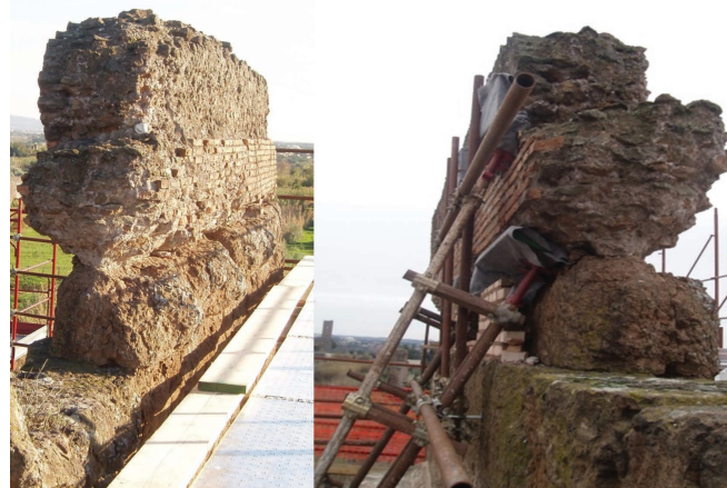
Fig. 10. Una porzione muraria residua dello speco dell'Anio Nuovo (sovrapposto a quello del Claudio) che appariva in bilico, poco prima del consolidamento, sui blocchi in peperino consunti, dimostrando la maggior resistenza al degrado rispetto al peperino.
