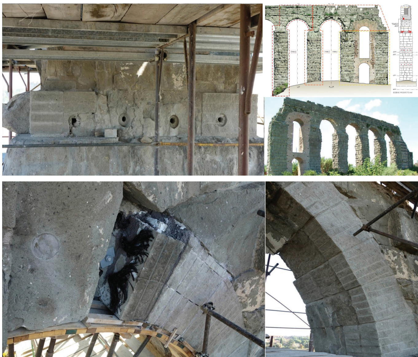
Fig. 14. Nel tratto delle sei arcate adiacente alla ferrovia sono stati condotti alcuni interventi di restauro e consolidamento sui i tre pilastri a destra nella foto d'insieme che dovrebbero essere replicati anche sugli altri. Le operazioni di restauro superficiale sono state affiancate da interventi strutturali miranti al consolidamento dei montanti 3 della ghiera d'arco d'estremità. Sono state parzialmente recuperate le perdite di materiale che avrebbero portato a evoluzioni pericolose del degrado e i pilastri sono stati cerchiati con tiranti inseriti per ripristinare la monoliticità originaria di alcuni blocchi in posizione strategica.
