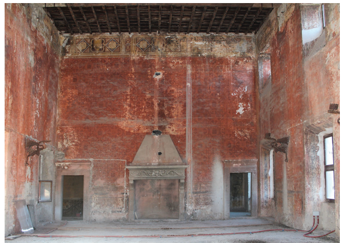
Fig. 14. La Sala degli Stemmi con estradosso della volta ricostruita in cemento armato e tracce dell'impianto elettrico. Completamente assenti finitura superficiale e pavimentazione (2019).
