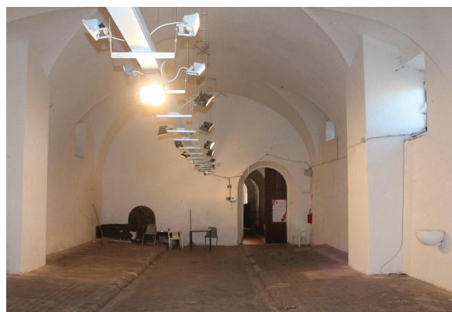
Fig. 3. Piano seminterrato: i piedritti del grande arco nella stalla ostruiscono parzialmente una finestra preesistente.
