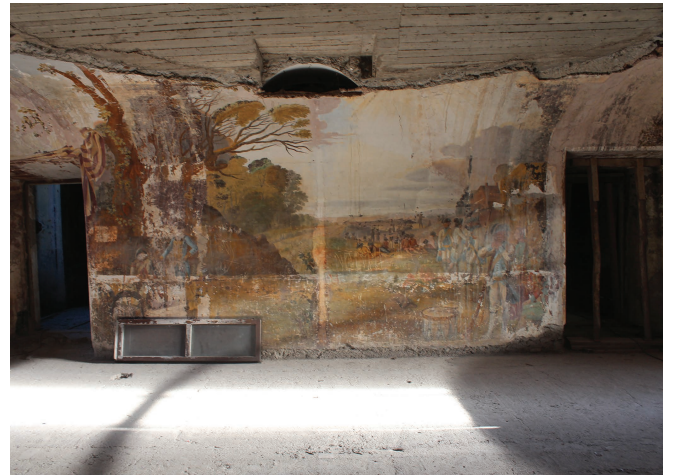
Fig. 12. La Sala Militare con le ripristinate lunette di epoca Braschi e la nuova struttura voltata che accompagna le pareti originali affrescate (2019).
