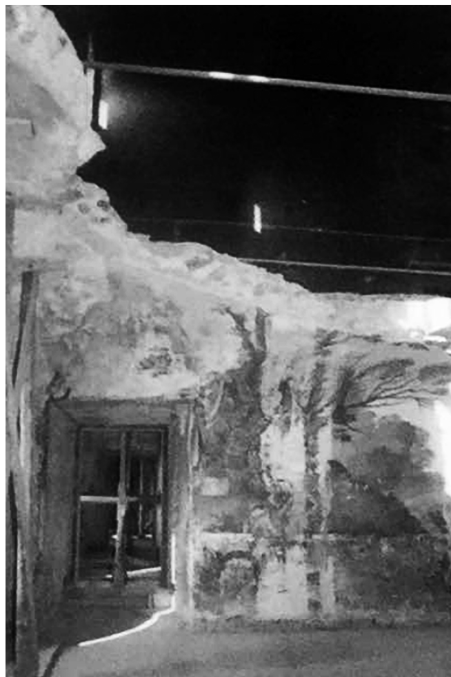
Fig. 9. Sezione della volta crollata in concrezione e catene metalliche del solaio superiore (da V. Brancaleoni, Il Palazzo Ruspoli di Nemi. L'avvio... , cit., p. 103).
