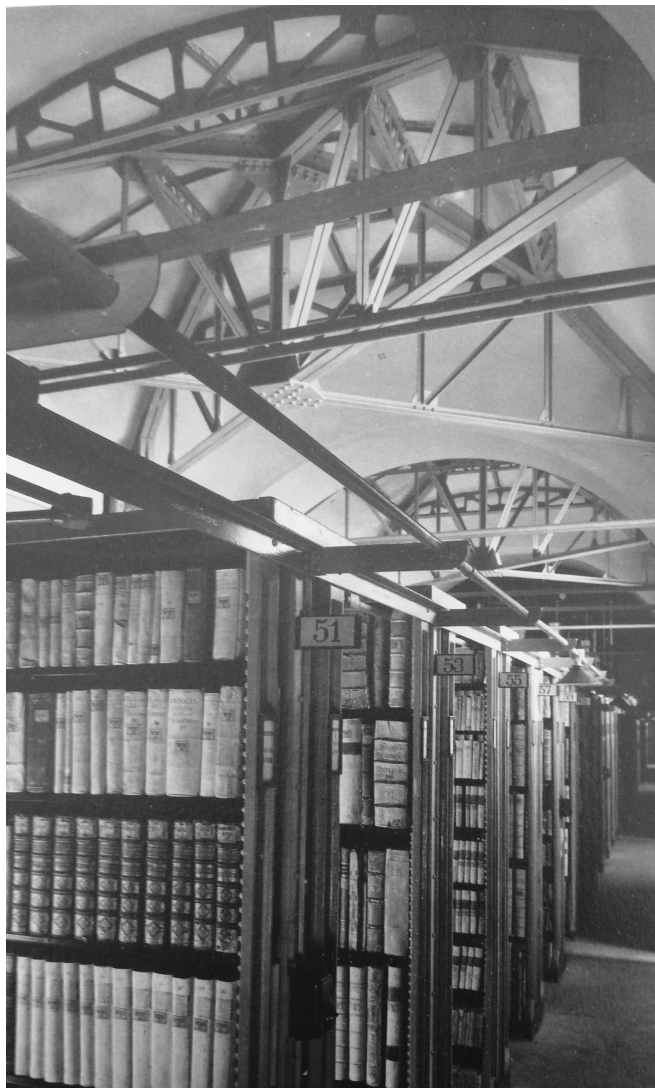
Fig. 6. Città del Vaticano, Biblioteca Vaticana, magazzino degli stampati con scaffalature in ghisa SNEAD e travature metalliche a rinforzo delle volte (da A. Rita, La Biblioteca Vaticana nelle sue architetture. Un disegno storico , in La Biblioteca Vaticana. Libri e luoghi all'inizio del terzo millennio , a cura di G. Guala, A. M. Piazzoni, A. Rita, Città del Vaticano 2011, p. 107, fig. 39).
