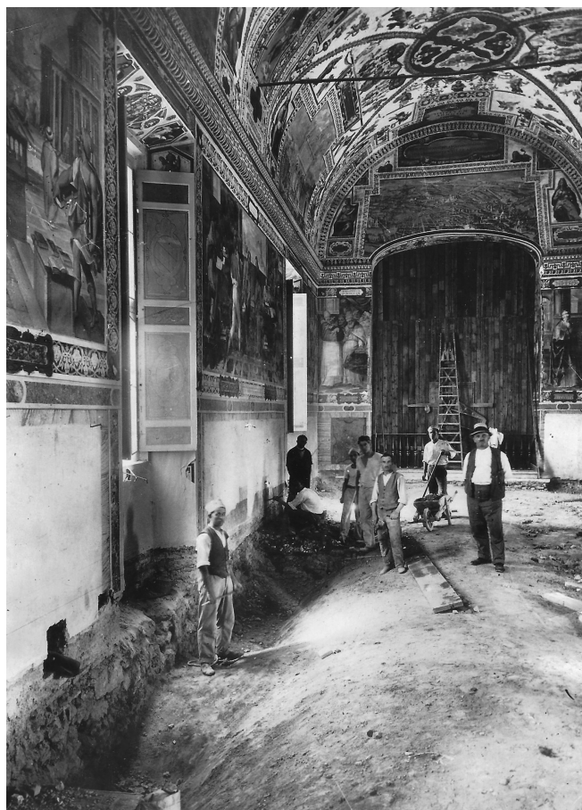
Fig. 13. Biblioteca Vaticana, opere di ricostruzione delle volte e del pavimento del Salone Sistino, 23 novembre 1932 (foto ACME-Newspicture, historicimage.com , A 122).
