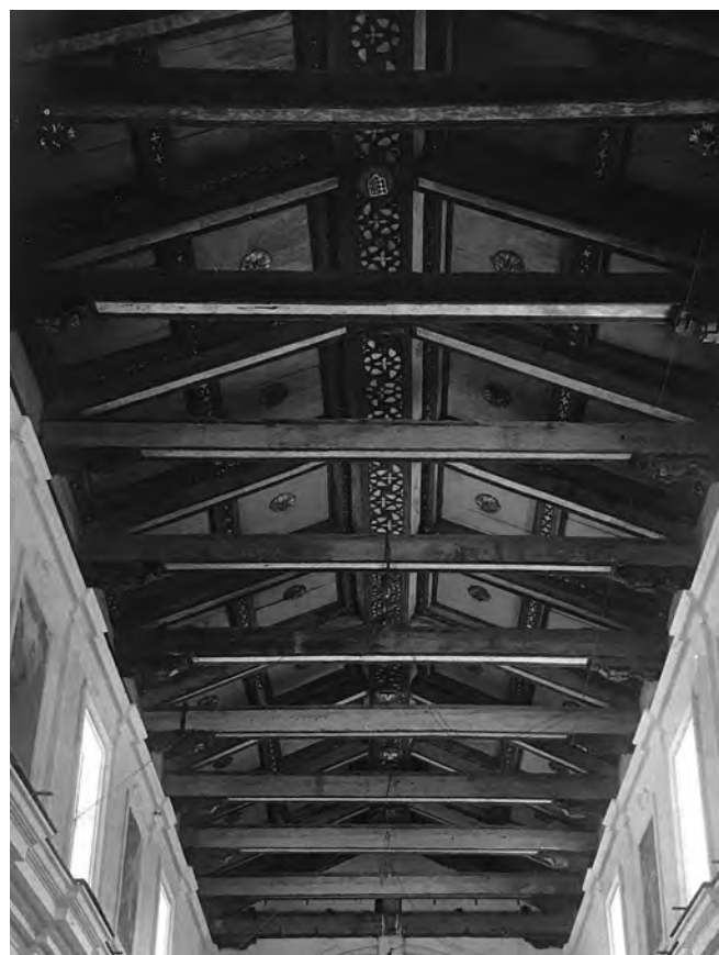
Fig. 7. Il soffitto ligneo cinquecentesco prima del restauro (da Rao, 1907).
